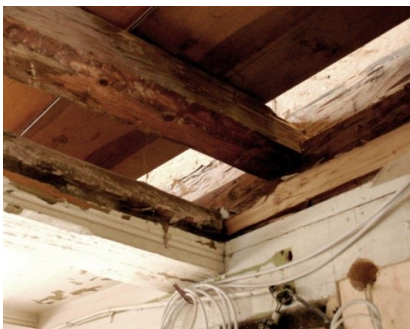
Abb. B-139: Auflagerbereich einer doppelten Decke (Rohbausituation während einer tief greifenden Sanierungsmaßnahme)
