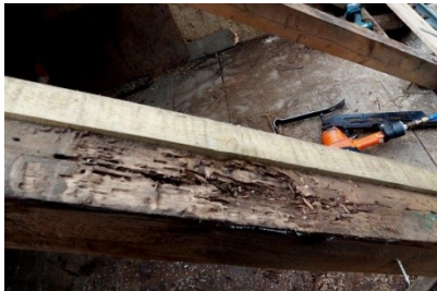
Abb. B-176 Braunfäule durch falschen Fensteranstrich / verdeckter Ameisenbefall zwischen Sparren und Schalung
